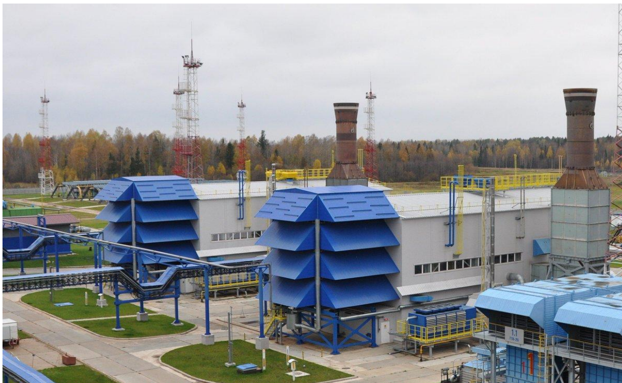
Фото №51. Укрытия для компрессорной перекачивающей станции
