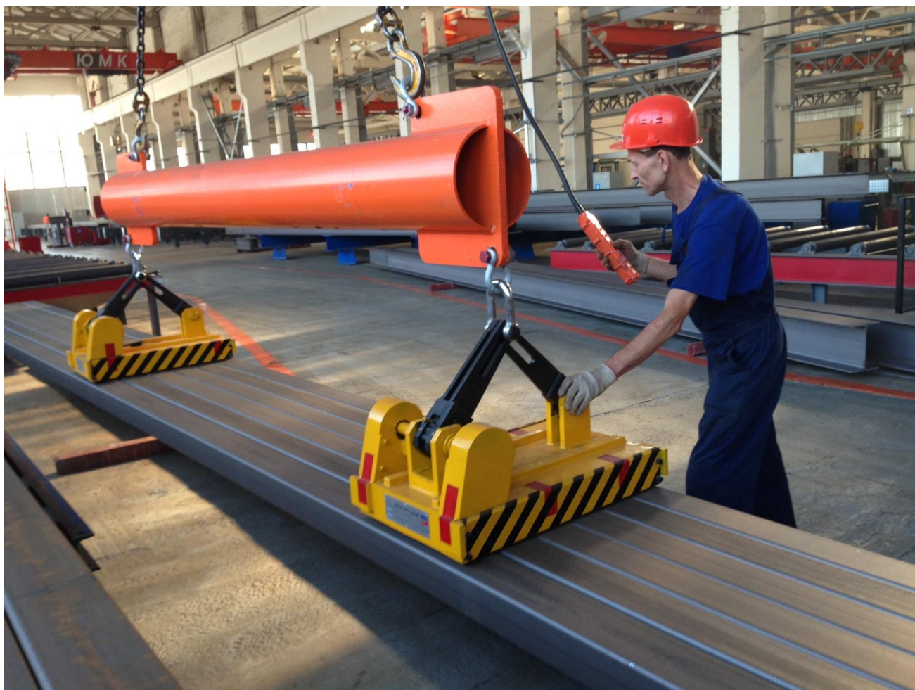
Фото №10. Использование магнитных траверс с самозахватывающим механизмом ускоряет погрузочно-разгрузочные работы (разгрузка профильных труб – от 3 до 7 труб за 1 цикл в зависимости от их типоразмера)
