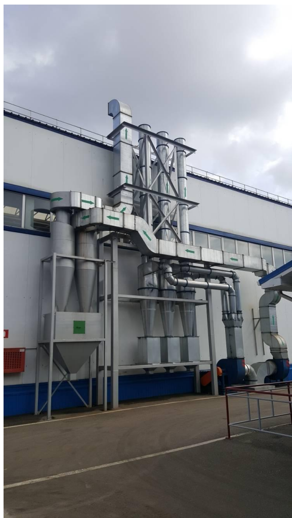
Фото №31 Цех оборудован вытяжной вентиляцией.
